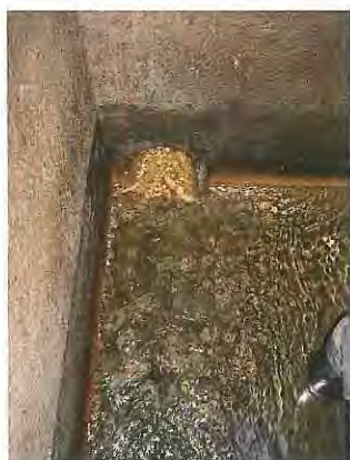
Trop plein du collecteur n°6
