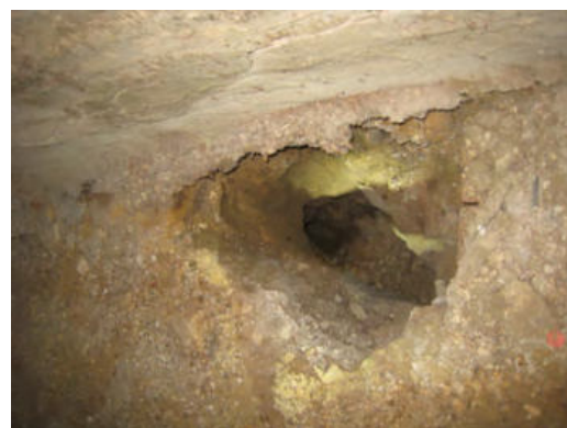
Photo 4: Effondrement survenu en 2014 dans la grange du 9 rue de la Chapelle (Ind. 109)
