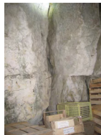
Photo 10: Ind 030, fractures, blocs instables.
