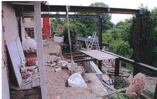
Photo 5: Habitation affectée par le glissement de terrain, Ind 010 (Photo juillet 2013, source : mairie)
