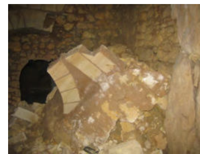
Photo 7: Chute de voûte (Ind. 071, 072, 254 et 255) au bas de la rue du Ronceray
