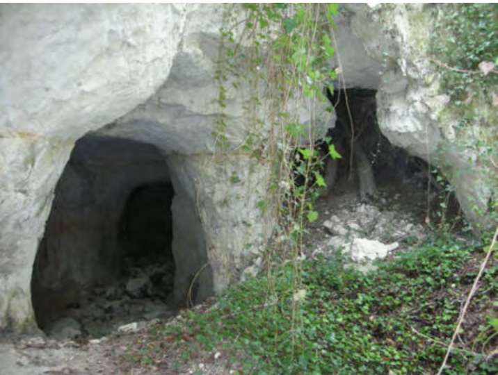
Photo 4: Ind. 020, zone d'effondrements dans la carrière
