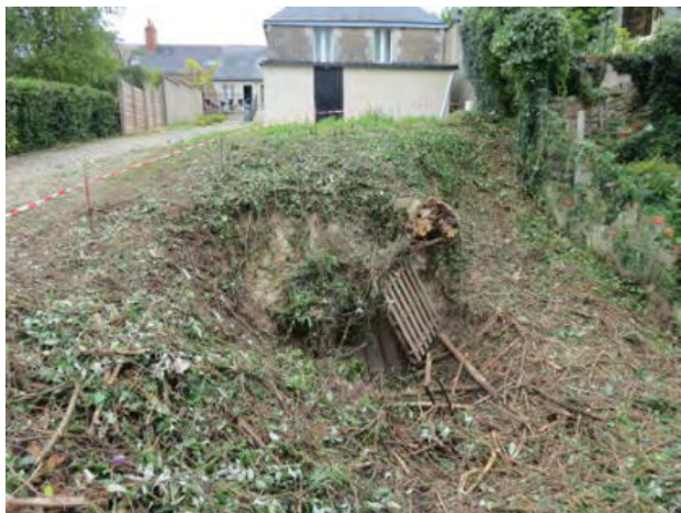
Photo 3: Cave présentant un risque d'effondrement dans le bourg (Ind. 015, 020 et 021)
