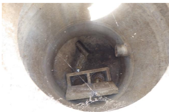
Dépôt – Réseau d'eaux usées – Devant la mairie -- R494
