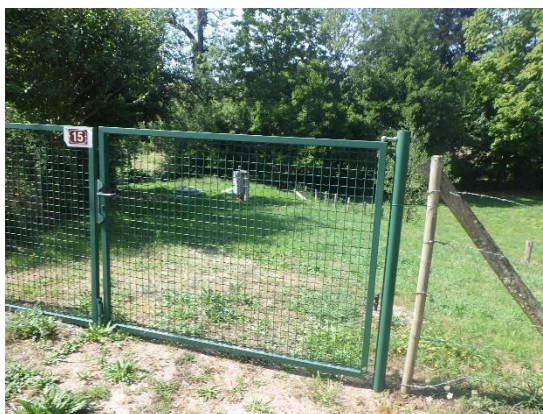
Poste de refoulement du système de Cadolon – vue extérieure
