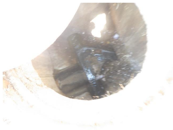
Traces de mise en charge– Chez un particulier – Réseau d'eaux usées – R69
