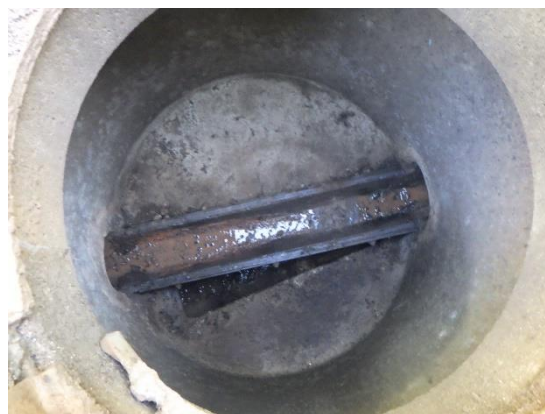
Déversoir d'orage n°2 route des Lavandières
