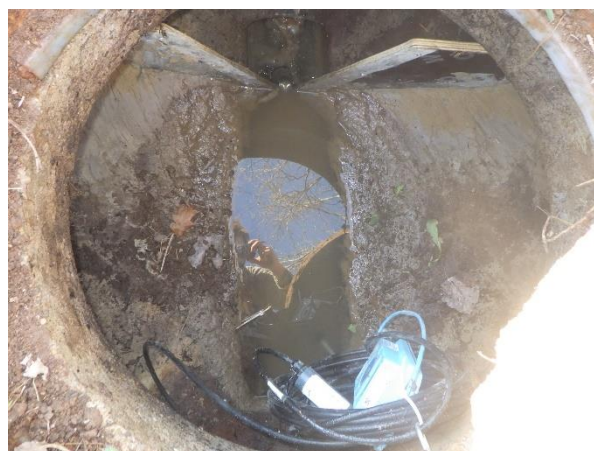
SYR3 - sonde piézométrique + seuil normalisé - Vue intérieure
