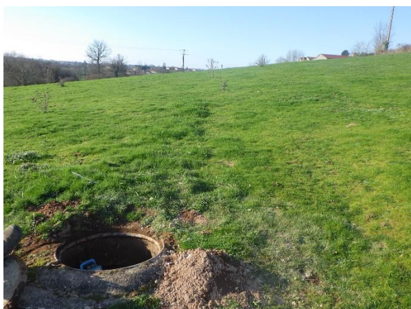
SYR2 - sonde piézométrique + seuil normalisé - Vue extérieure
