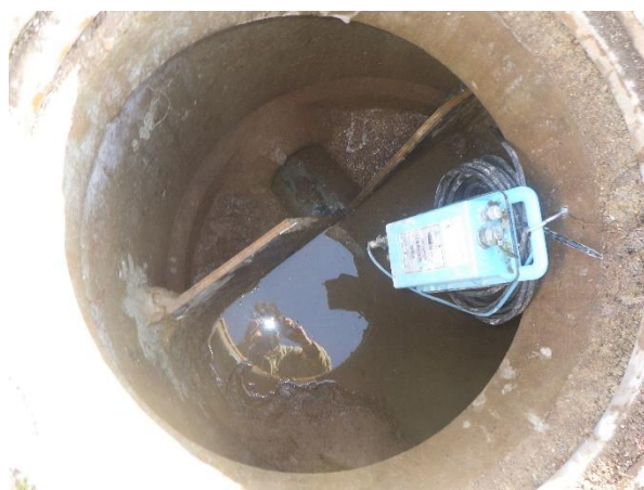
SYR2 - sonde piézométrique + seuil normalisé - Vue intérieure
