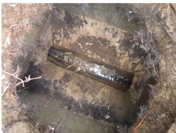
Infiltrations – Parcelle en contrebas de la rue de la Vercherie – Réseau d'eaux usées – R1468
