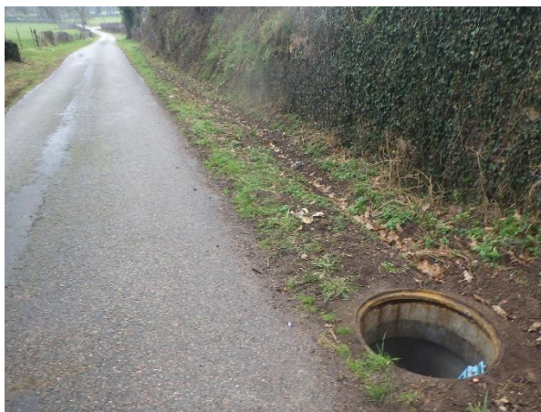
SYR4 - sonde piézométrique + seuil normalisé - Vue extérieure
