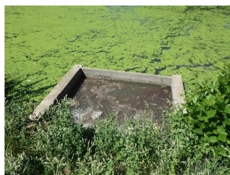
Entrée de la station de traitement
