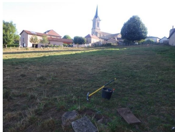
Tampon cassé, fissuré – Champs en contre-bas de la route de Thizy – boîte de branchement d'eaux usées – ID 434
