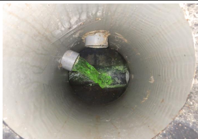
Colorant dans le regard privé des eaux usées
