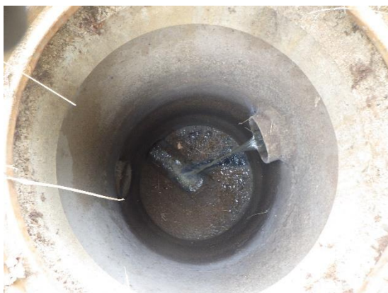
Déversoir d'orage n°1 en entrée de la station de traitement des Traives
