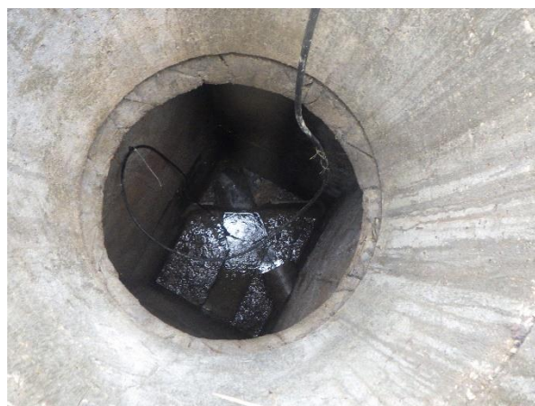
SYR1-seuil normalisé + sonde piézométrique - Vue intérieure
