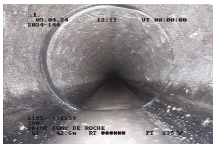
Déplacement d'assemblage - décentrage radial à 6h
