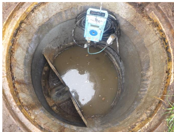
SYR4 - sonde piézométrique + seuil normalisé - Vue intérieure
