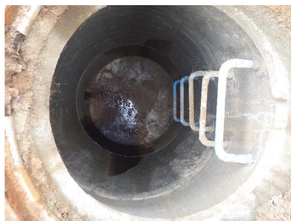
Traces d'infiltrations – Parcelle en contrebas de l'entreprise SERS Racing, à proximité de l'Aron – Réseau d'eaux usées – R1458
