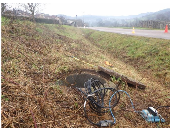
SYR1-seuil normalisé + sonde piézométrique - Vue extérieure
