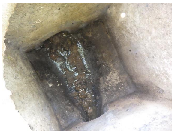
Dépôts, absence de radier –route des Tronchères– Réseau d'eaux usées – R1090
