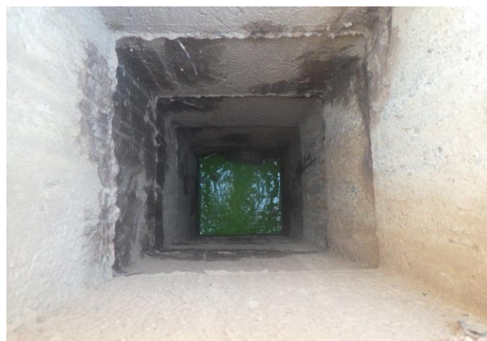
Colorant dans la boîte de branchement des eaux usées
