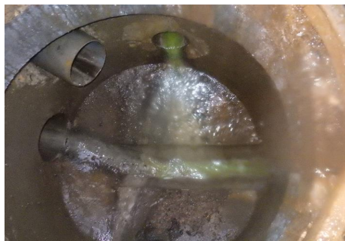
Colorant dans le regard de visite des eaux usées
