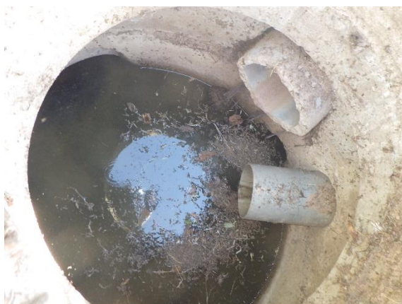
Traces de mise en charge – Chez un particulier – Réseau d'eaux pluviales – R339
