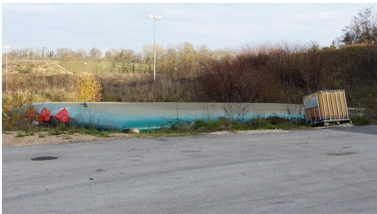
Réserve incendie à l'angle Nord du bâtiment, photographie prise le 29.11.2023
