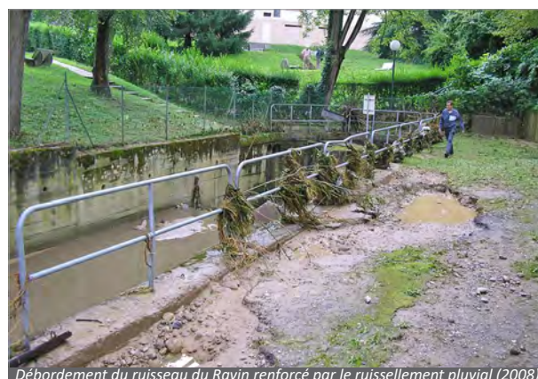
Débordement du ruisseau du Ravin renforcé par le ruissellement pluvial (2008)
