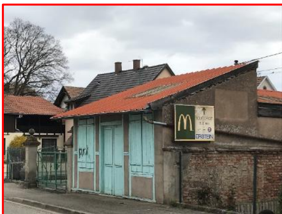
préenseigne sur façade (entretien ; hauteur > égout du toit)
