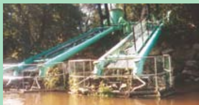
Pompage pour l'alimentation d'une pisciculture
