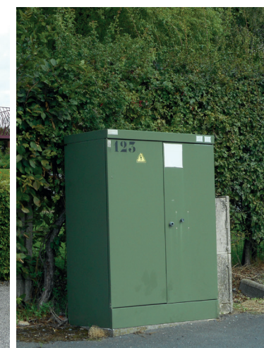
Fontaine-au-Bois - Armoire électrique intégrée par la couleur verte
