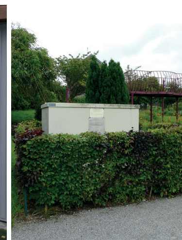
Le Favril - Armoire électrique intégrée par une haie d'essences locales
