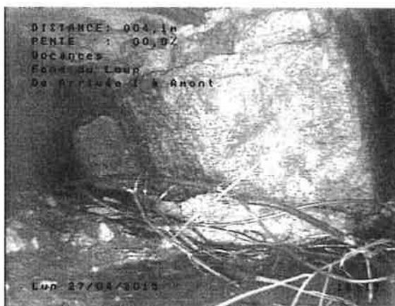
Photographie n° 5 : Présence de développement de racines, ici à 4,10 m au niveau d'une ramification du drain.
