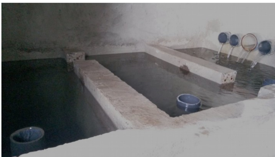
ARRIVÉE DES DRAINS DANS LE CAPTAGE
