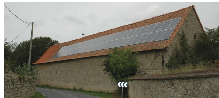
Beuvrequen - panneaux photovoltaïques
