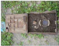
Bouche Incendie de 80 mm à tenons
