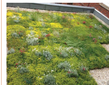
Toit végétalisé, agréable dans l'environnement, favorisant la biodiversité en apportant des solutions pour la gestion de l'eau et les énergies
