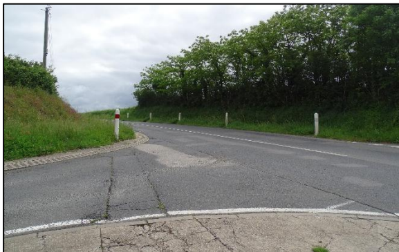
Intersection dangereuse entre la rue des Gagères et la RD 904
