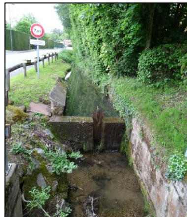
Discontinuité sur le Marmont
