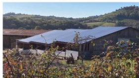
Vesvry - panneaux photovoltaïques sur toiture. (Jean-François Biond (AEP - DRAE BFC))
