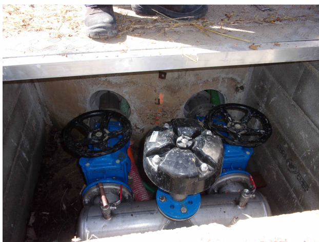
Local situé à proximité du puits et refermant les vannes ainsi qu'un robinet de prélèvement pour analyses
