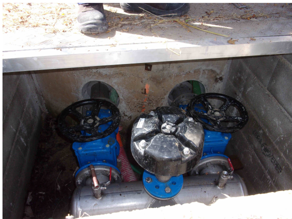
Ouvertures vers le puits de La Fontaine à rendre étanche
