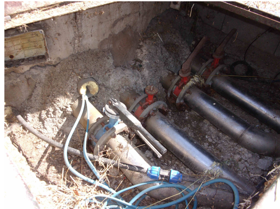
Regard désaffecté à combler
