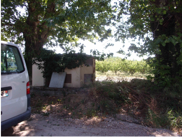
Transformateur près de la clôture du Périmètre de Protection Immédiate
