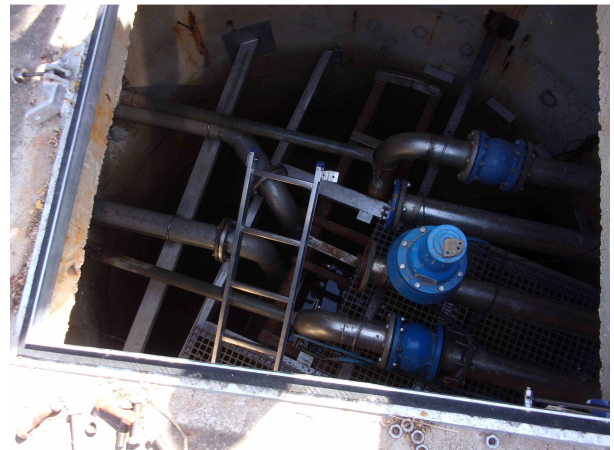
Intérieur de l'ouvrage avec la plate forme métallique et les différentes canalisations d'exhaure
