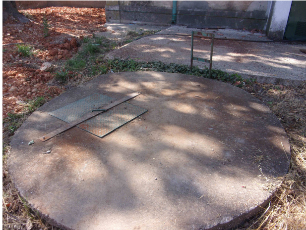
Puits désaffecté à combler
