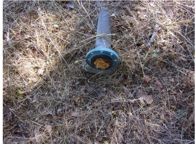
Canalisation inutilisée à enlever
