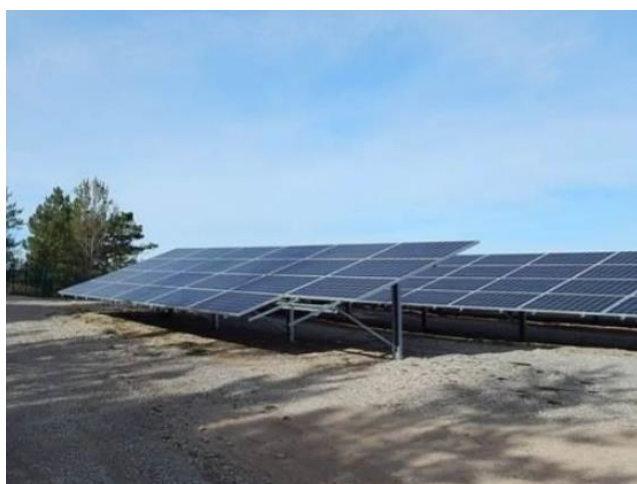
Figure 4 : Exemple de table fixe de modules (Source : Etude d'impact – Parc photovoltaïque de l'Ecarpière – Commune de Gétigné (44) – Août 2019 – BURGEAP SUD EST)
