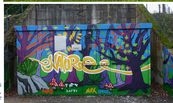
Intégration de transformateurs électriques au moyen de décors peints (pouvant être réalisé par les habitants, élèves, associations...) - hors territoire
