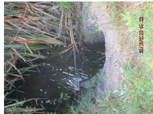
E5 – Bassin rétention rue de la Chennerie
