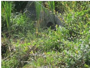
E4 – Bassin rétention rue de la Chennerie
