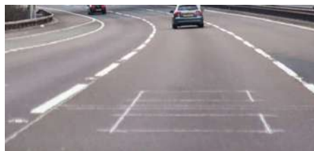
Boucle inductive en saignée dans la chaussée
