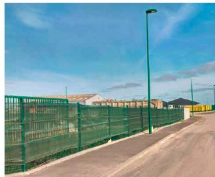
Clôture en grillage rigide verte avec bâche de protection.
