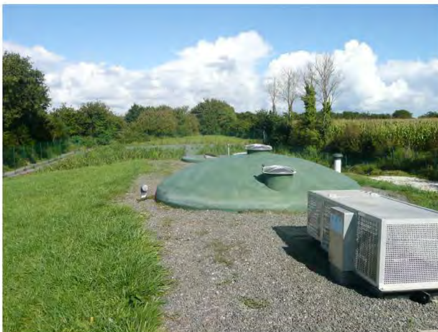
Figure 10 Photographie du décanteur-digester de la station d'épuration de Rostiviec
