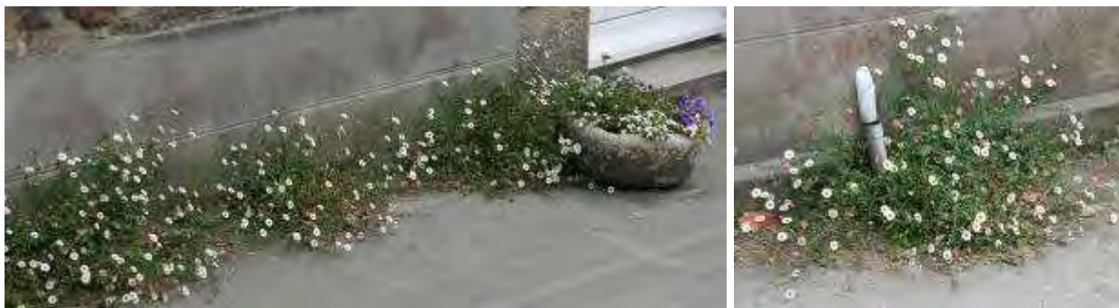
Exemple de colonisation de pied de façade
