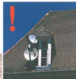
En aucun cas une lucarne ne doit servir à fixer une antenne ou parabole.
