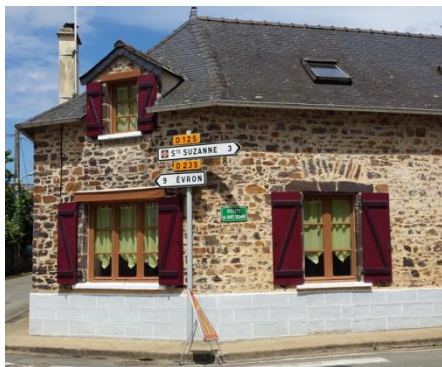
« Dissonance » entre matériaux traditionnels et rénovation d'une assise en parpaings, Chammes (Source : Even Conseil)
