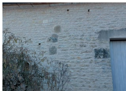
Trous dans les murs en moellons (Source : Cittanova)
