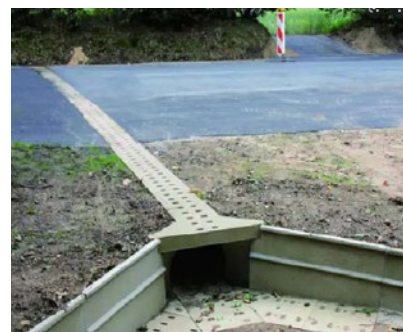
Exemple de passage à faune-crapoduc (Source : Aco)
