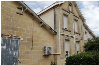
Système de ventilation en façade (Comps)
