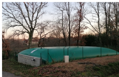
Citerne souple pour réserve incendie (Samonac)
