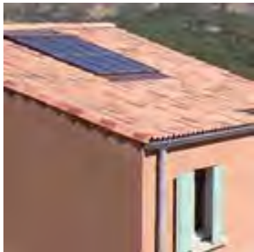
Exemple satisfaisant d'intégration de capteurs
