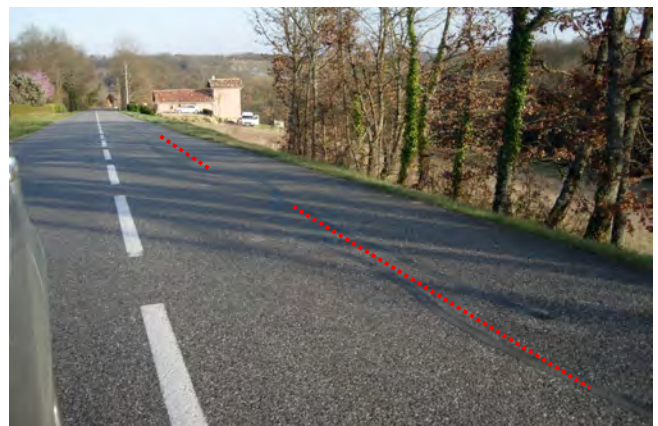
R.D. 2 Affaissement de remblai
