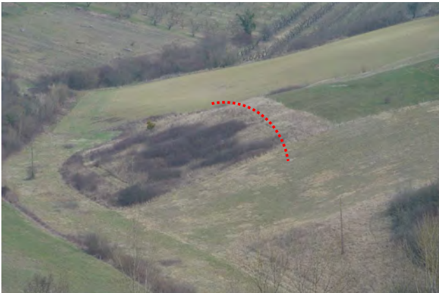
Lieu dit « Magnes » Glissement supposé
