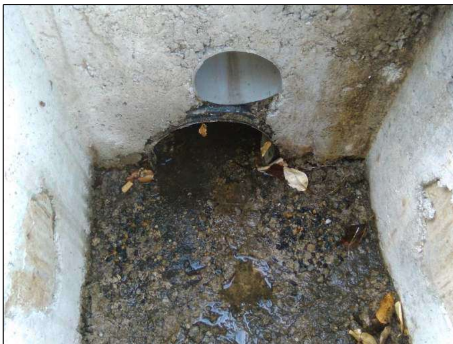
Figure 62 : Exemple d'une canalisation bouchée
