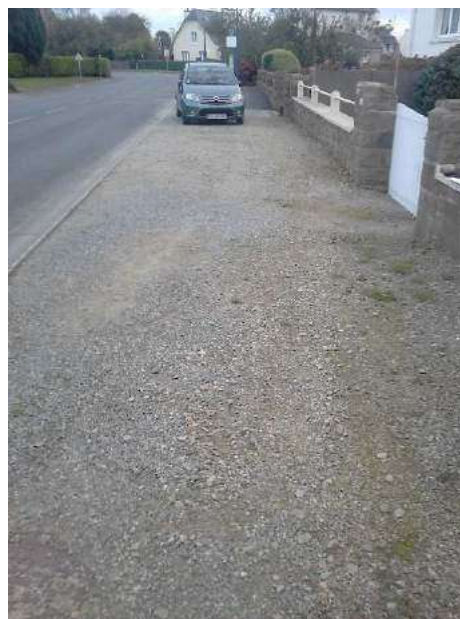
Figure 65 : Problème de ruissellement des eaux pluviales 4 route de Primel
