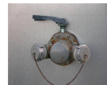
Prises directes de 100 mm sur réserve
