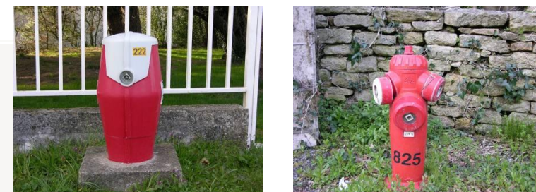
Exemples de numérotation de poteaux incendie
