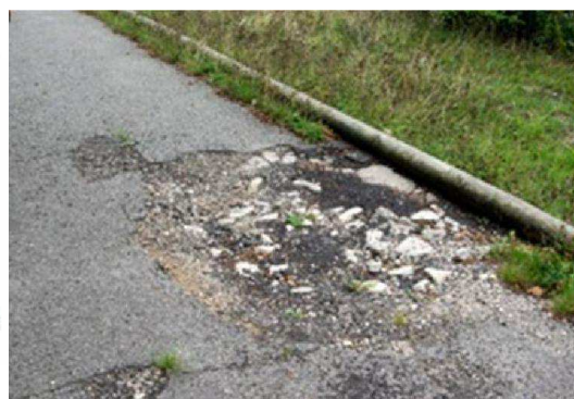
Aperçu de l'affaissement survenu sur le chemin latéral du bois de la Tussion à Villepinte, en 2008.
