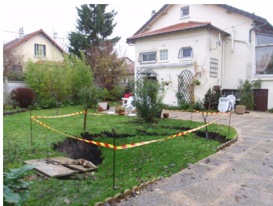
Fontis observé en 2008 sur la commune de Sevrans (Crédits photo : IGC Paris)
