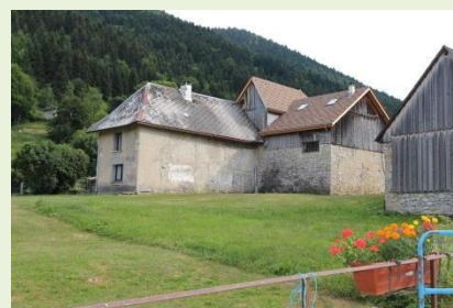
Présence d'herbe jusqu'au pied du bâti
