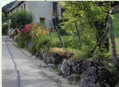
Soutènement léger, 1 ligne de blocs de pierres accompagnée de végétal
