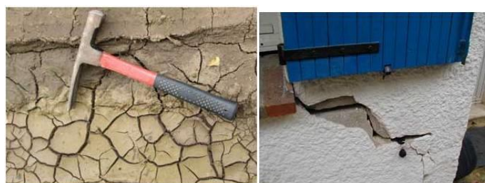
Figure 48 : Représentation des dégâts liés au risque retrait/gonflement des argiles
