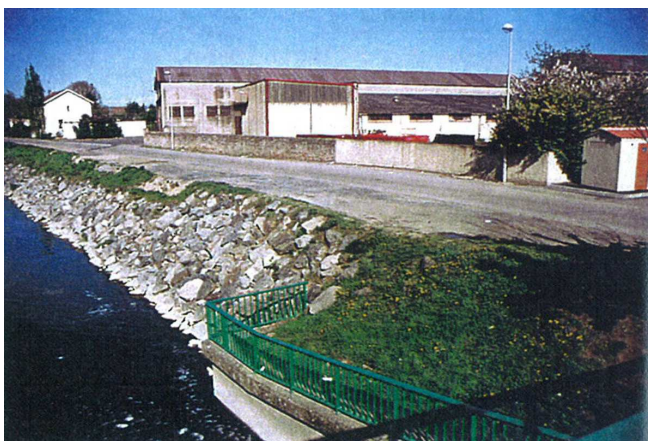
Espaces stériles et rudéralisés : les enrochements ont stérilisé les berges
