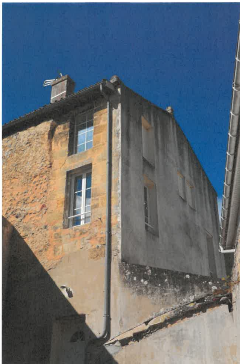
Gouttereau est, traces d'arrachement.
