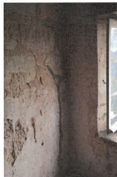
Comble, détail de l'enduit. Phot. Florian Grollimund IVR72_20143304927NUC2A
