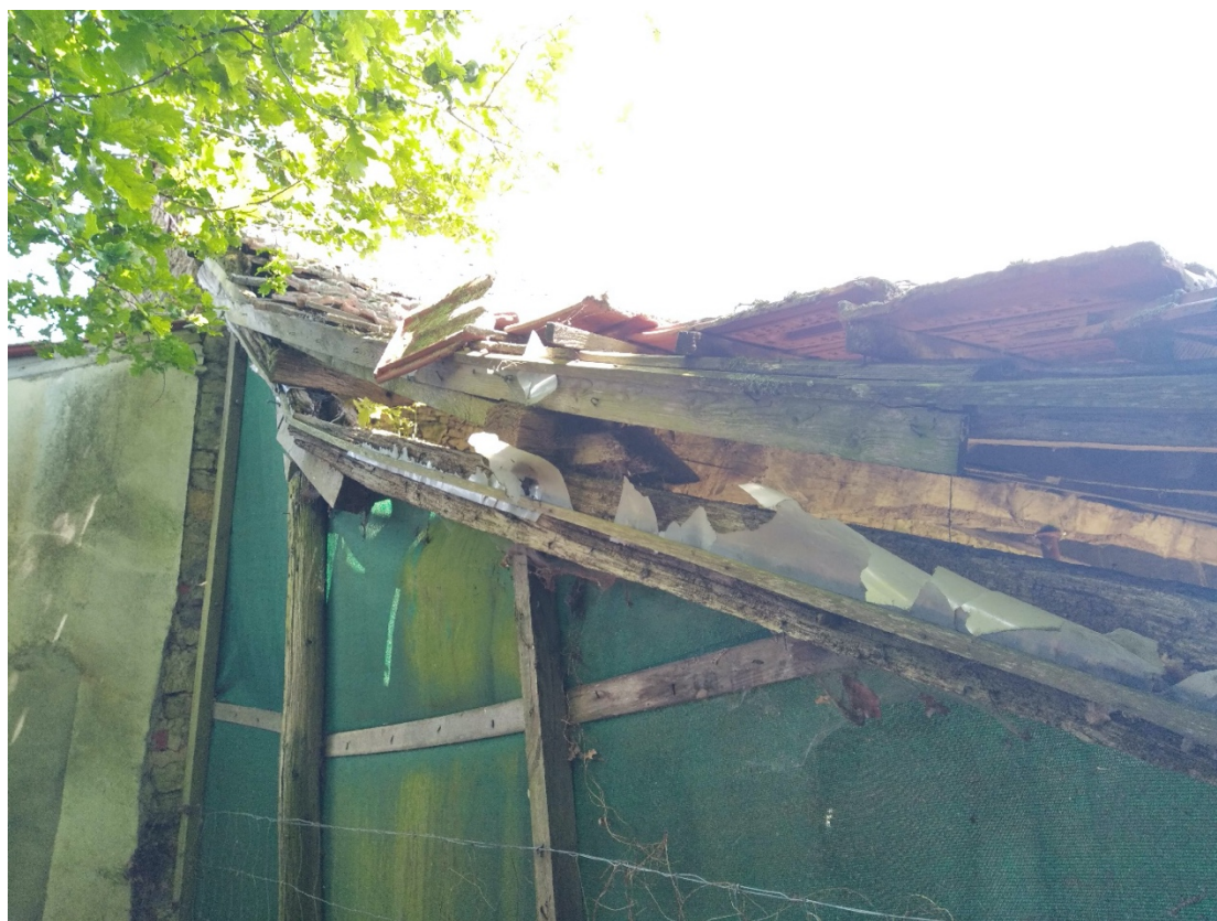
Appentis en mauvais état
