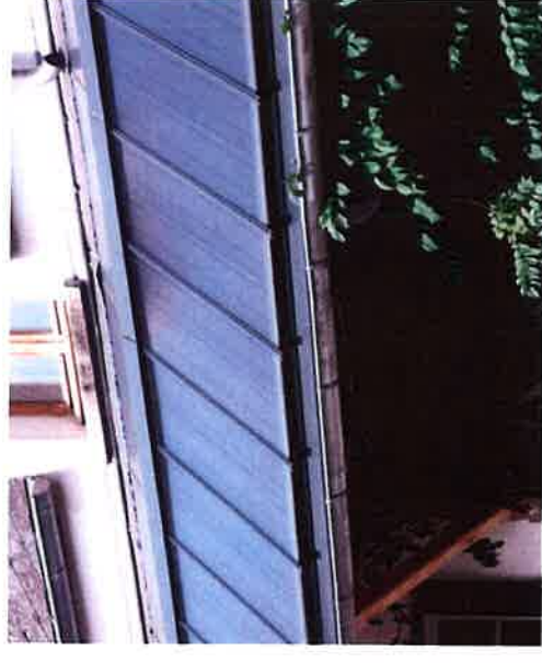
Les capteurs sont utilisés comme auvent. Orientés nécessairement au sud, ils seront également efficaces comme protection solaire.
