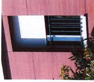
Le coffre du volet roulant est ici discrètement dissimulé derrière la viture
