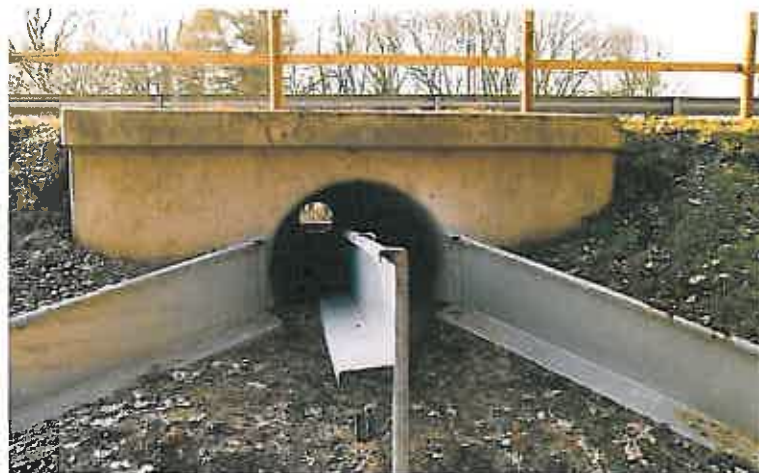
Crapauduc installé en Allemagne (adaptation à une infrastructure routière existante). (Crédit photographique : Christian Fischer)
