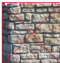
Joints creux en ciment
