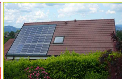
Bon exemple d'intégration de panneaux solaires sur une toiture
