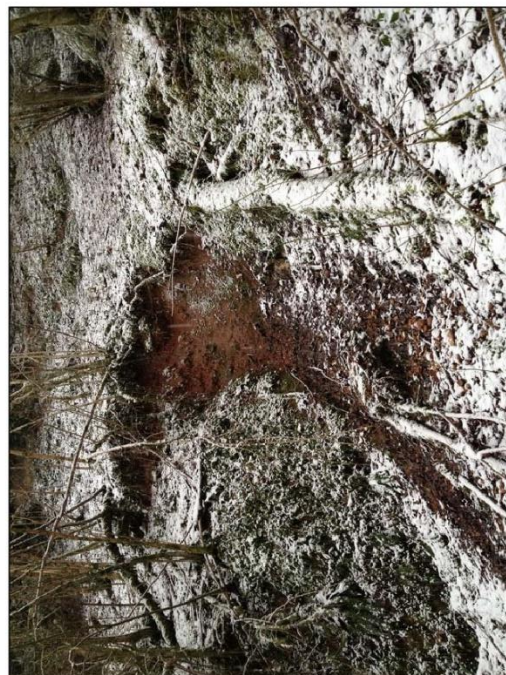
Glissement de la couche superficielle altérée
