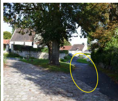
Rupture constatée dans le traitement de sol homogène (pavés) de la place du village.
