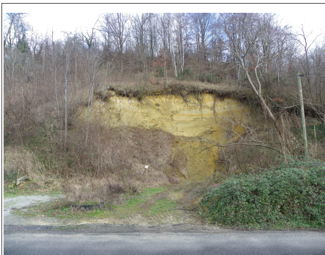
Figure IV.41: Glissement actif, hameau de Grimaucourt
