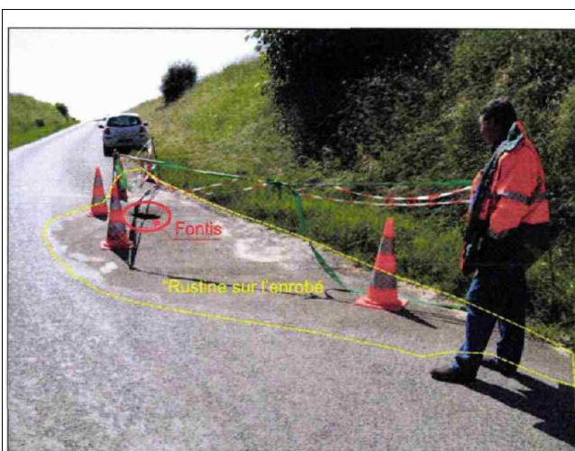
Figure IV.17: Localisation du fontis, BRGM, 2008
