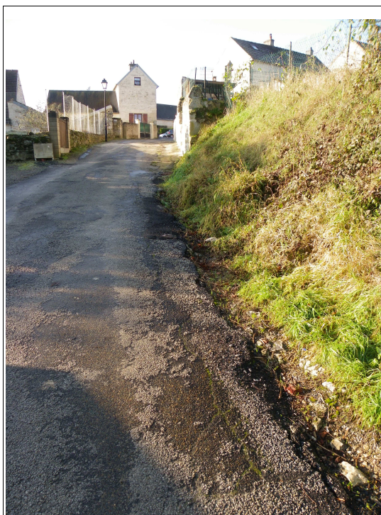
Figure IV.7: Voirie endommagée par le ruissellement (rue de la Margelle)
