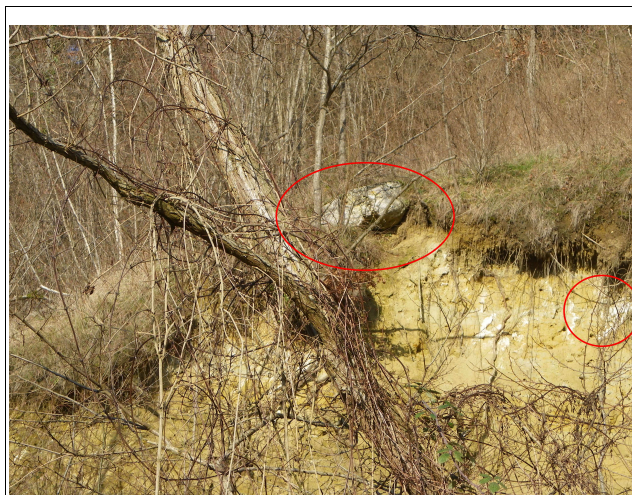
Figure IV.42: Blocs suspendus ou pris dans le glissement
