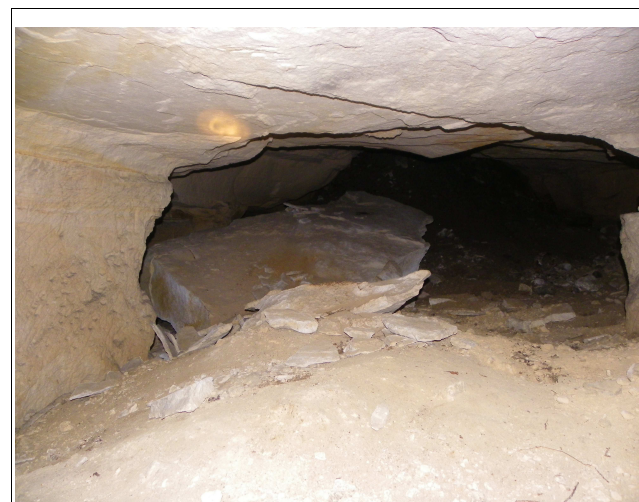
Figure IV.40: Carrière n°2 - Four d'en haut - toit effondré
