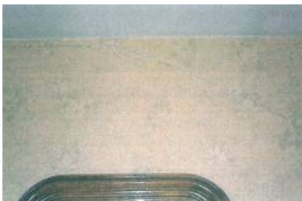
Fissuration intérieure, tapisserie déchirée - Maison André.
