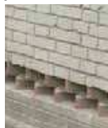
Jeux de brique créant une aération
