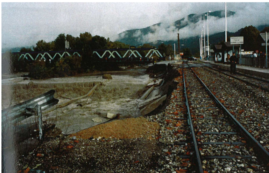
Crue de novembre 1994 Erosion de la voie ferrée en rive gauche à l'aval du seuil 7 (arrêt de la Manda)
