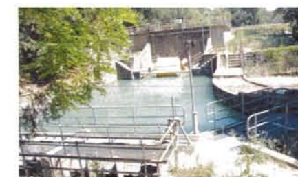
Station de pompage du Canal des Alpines (Sources : CA13, 2012)
