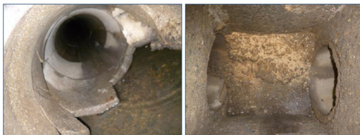
Figure 21 : Prises de vue de tronçons détériorés (rue nationale)
