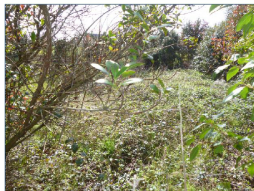
Figure 25 : Prise de vue du bassin de rétention envahi par la végétation, avril 2016
