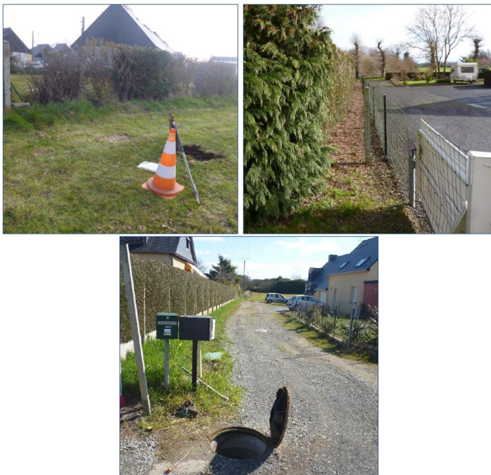
Figure 19 : Prises de vue des trois passages du réseau pluvial en parcelles privées
