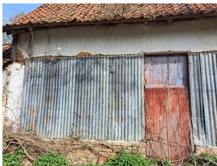
La tôle n'est pas la solution pour remplacer du torchis. Un enduit chaux-sable ou un bardage bois permet la préservation du patrimoine.
