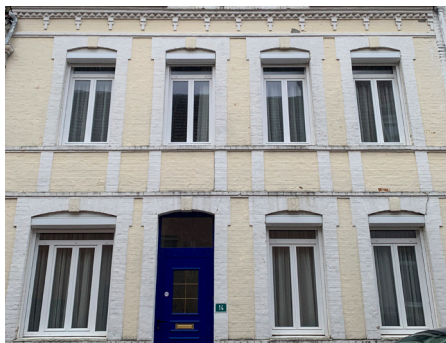
Coffre des volets roulants placé devant les impostes, la lumière naturelle ne peut donc pas pénétrer dans le logement.
