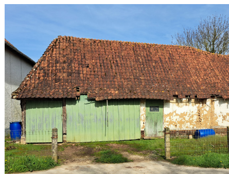
Couvrir le torchis par un bac acier entraîne une perte du caractère patrimonial.
