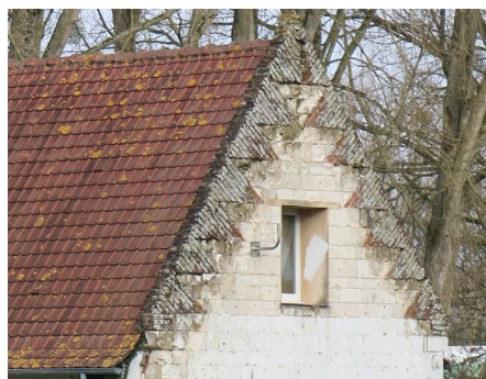
Les briques peuvent moisir à cause de l'eau stagnante, il est nécessaire de les restaurer pour assurer leur pérennité.
