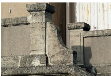
Garde-corps de terrasse avec entablements et piliers en pierre dure.
