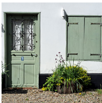
Ferronneries porte et volets.
