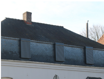
Toiture mansardée en ardoise, cependant les fenêtres de toit sont mal intégrées, il est nécessaire de les aligner aux travées existantes, et il est préférable de les encastrer dans la toiture.
