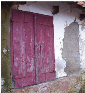
Présence de ciment
