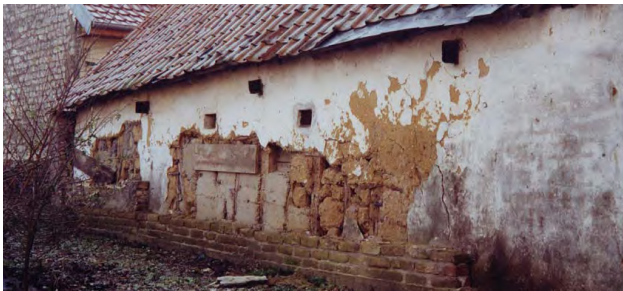
Mauvaise gestion des eaux de pluie
