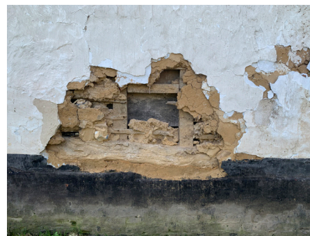
Désordres sur un mur en torchis, on peut observer les différentes étapes : lattis, torchis, enduit chaux et sable, badigeon à la chaux et enduit au coaltar.
