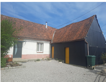
Le choix des matériaux, ainsi que la porte d'entrée, ne sont pas compatibles avec le patrimoine. Le projet doit être plus discret.
