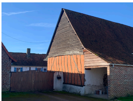
Privilégier l'emploi de briques similaires à celles du reste du bâtiment, ici le matériau appauvrit le pignon.
