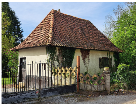
Coyau sur l'ensemble des pans de la toiture, protège les murs en torchis.
