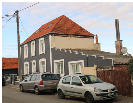
Les pas-de-moineaux de l'extension ainsi que les ouvertures ne respectent pas l'ordonnancement de façade de la maison.
