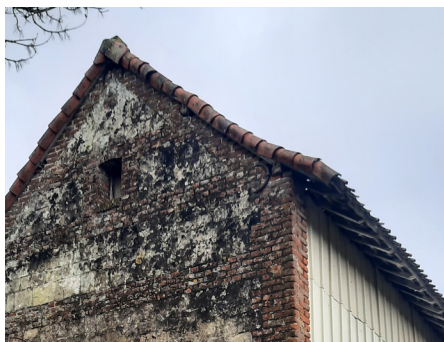
Coyau qui protège la façade.
