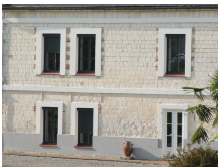
Les encadrements d'ouvertures réalisés ne respectent pas les caractéristiques de l'ancienne façade (probablement en brique.)
