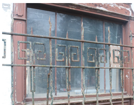
Entretien des ferronneries, il est important de les protéger de la rouille pour préserver ces ouvrages qui témoignent de savoir-faire qui disparaissent peu à peu.
