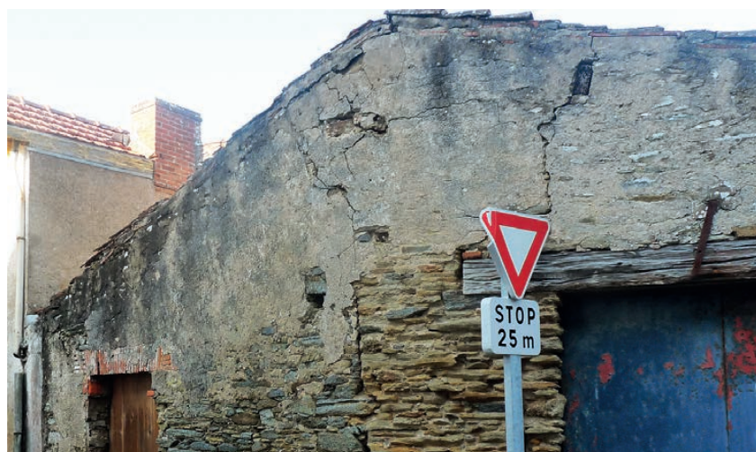
Cet ancien bâtiment présente des manques et des lézardes qui nécessiteront une restauration adaptée à ses maçonneries de moellons et de mortier de chaux.
