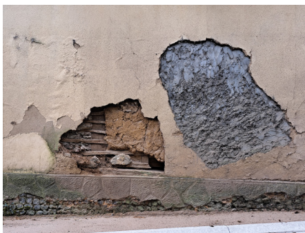
Mur en torchis "réparé" avec du ciment.
