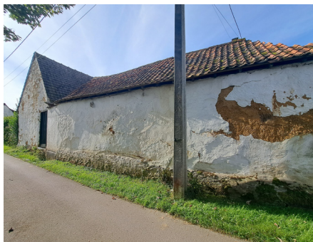
Fermette dont la dépendance en front de rue perd progressivement son badigeon à la chaux, le torchis est donc vulnérable aux intempéries.
