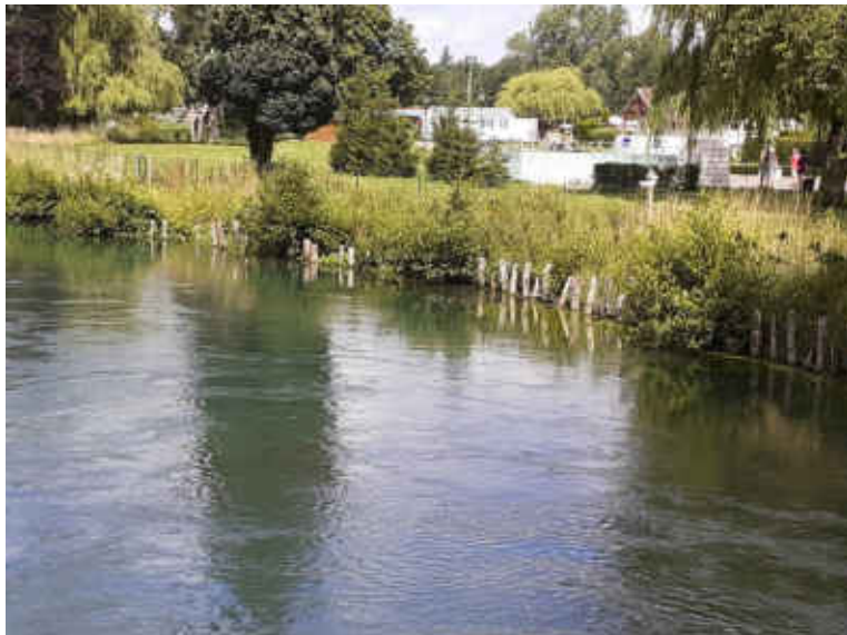
Tunage non adapté au débit / dégradé
