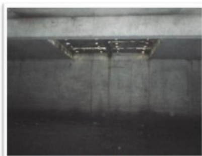
Bassin enterré Bailly à Dijon – accès
